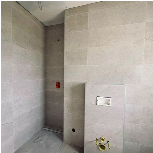
Exclusieve douche met design ligbadinstallatie en hoogwaardige wandtegels – luxe badkamerdesign op het hoogste niveau!
